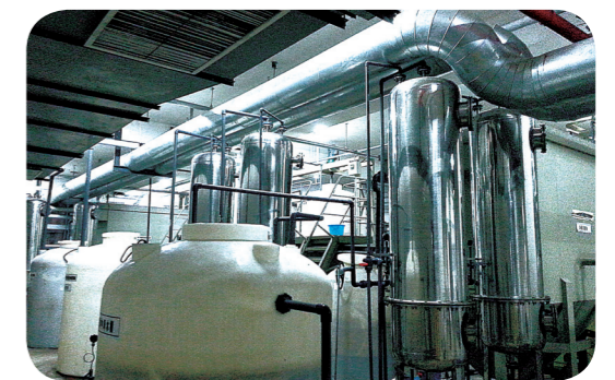
矿冶总院研发中心污水处理站
